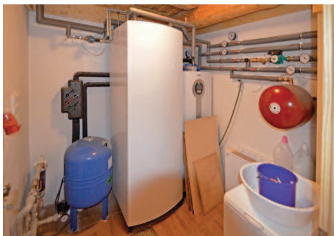
TECHNICKÁ MÍSTNOST S TEPELNÝM ČERPADLEM ZEMĚ-VODA, AKUMULAČNÍM ZÁSOBNÍKEM NA TEPLOU VODU A TLAKOVOU NÁDOBOU DOMÁCÍ VODÁRNY
